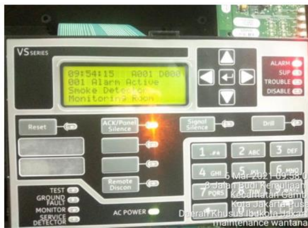
Smoke Detector Monitoring Room berfungsi dengan baik
