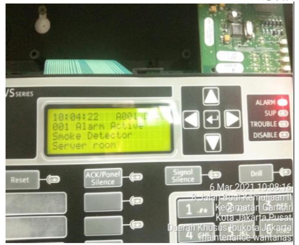
Smoke Detector Server Room dalam kondisi baik
