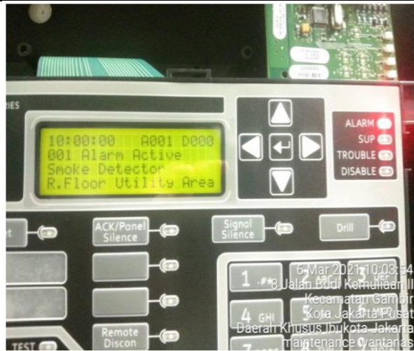
Smoke Detector Raised Floor Utility Area berfungsi dengan baik
