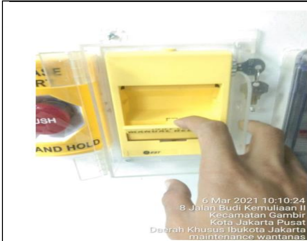
Manual Release dalam kondisi baik
